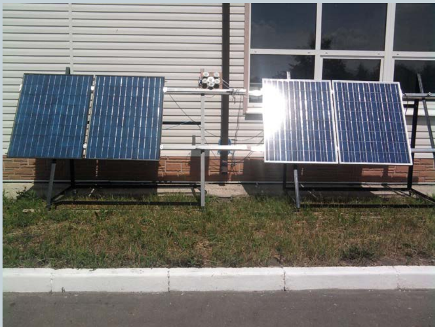
Солнечные батареи Solar Centrum Algoi, установленные в ООО «Интертехнопарк», г. Орёл
