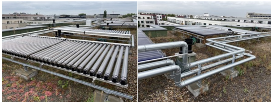
Abb. 1: Solarkollektoren einschließlich Anbindeleitungen auf dem Dach (Fotos: Julia Raab)
