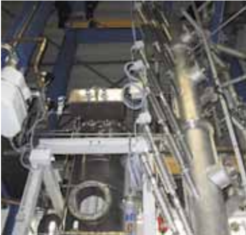
Abbildung 4: BioSyn-Vergasungsanlage im technischen Maßstab, ohne Isolierung.
