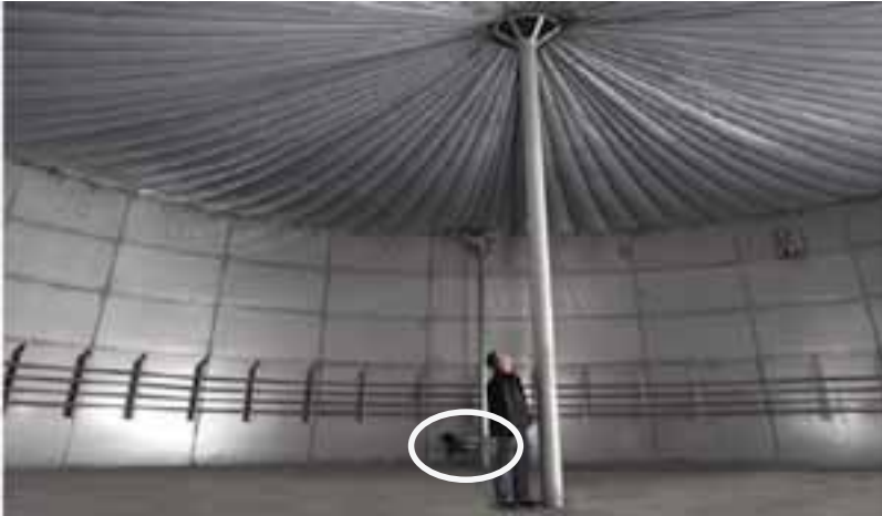
Abbildung 1: Edelstahlbiogasreaktor, Innenansicht mit Tauchrührer im Hintergrund, Foto: ThyssenKrupp Stainless AG.
