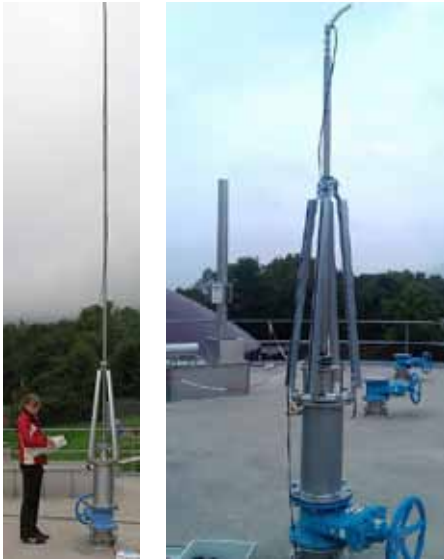
Abbildung 5: Zugangsschleuse für Messsonde, die an einer 6 m langen Lanze in den Reaktor getaucht wird
