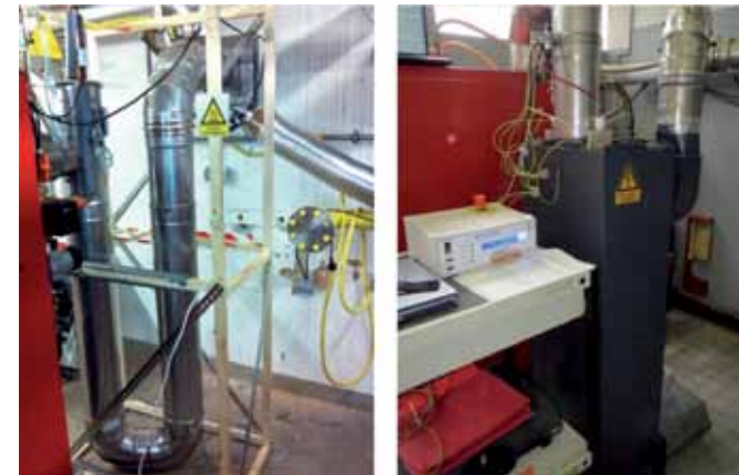
Abbildung 6: Testaufbau Hoval Stückholzkessel mit nachgeschaltetem Filter (links IZES Gebäude, AgroLyt 50) und mit integrierter Filterbox (rechts Hoval Werk AgroLyt 25)
