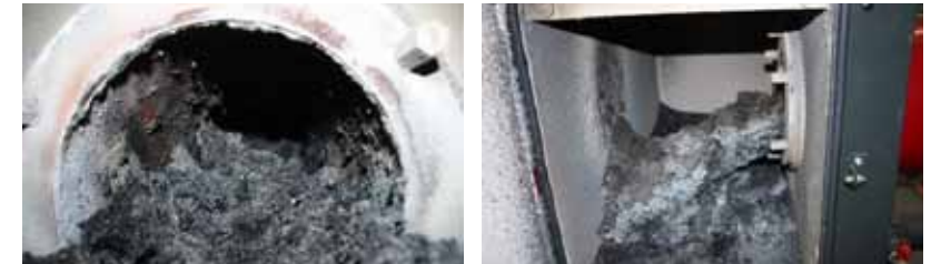
Abbildung 1: Verschlackung bei Einsatz von gehäckseltem Winterweizenstroh (Quelle: DBFZ)
