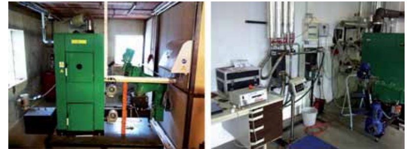
Abbildung 9: Testaufbau Biokompakt Hackschnitzelkessel mit integriertem Filter (Links: IZES Kundenanlage, rechts Biokompakt-Werk)
