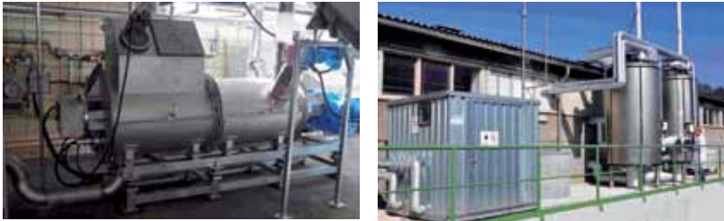
Abbildung 4: Hydrolysereaktor (links), Pilot-Biogasanlage (rechts)
