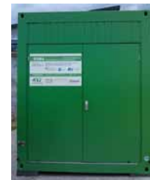
Abbildung 2: Aufstellung der VESBA an einer Biogas-Großanlage zur Langzeituntersuchung im Feldbetrieb
