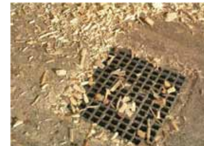
Abbildung 4: Bodenkamin für Warmluft zur Hackschnitzeltrocknung am Biomassehof Achenal
