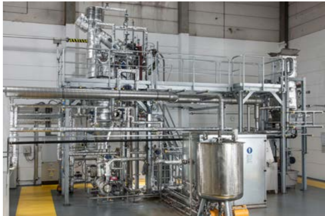
Abbildung 2: HTC-Anlage der Firma SunCoal Industries GmbH
