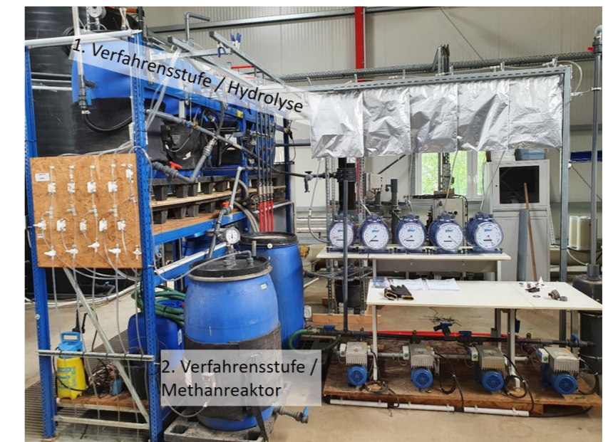
Abbildung 8: Gesamtansicht Demonstrationsanlage nach Umbau und Einbindung des AEV-Mehrphasenabscheiders (© GICON)
