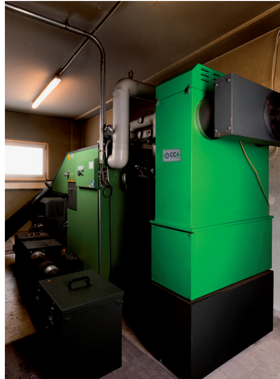
Abbildung 2: Testanlage mit HDG-Kessel und Abscheider CCA-100
