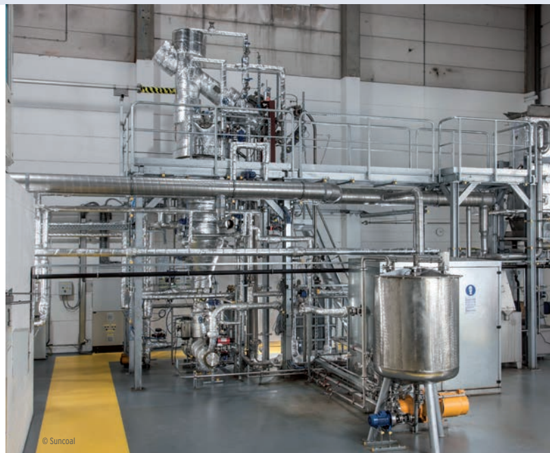
Abbildung 1: HTC-Anlage der Firma SunCoal Industries GmbH
