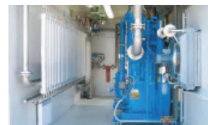
Biogas treatment facility Bruck an der Leitha, photo: ARGE Kompost & Biogas Österreich
