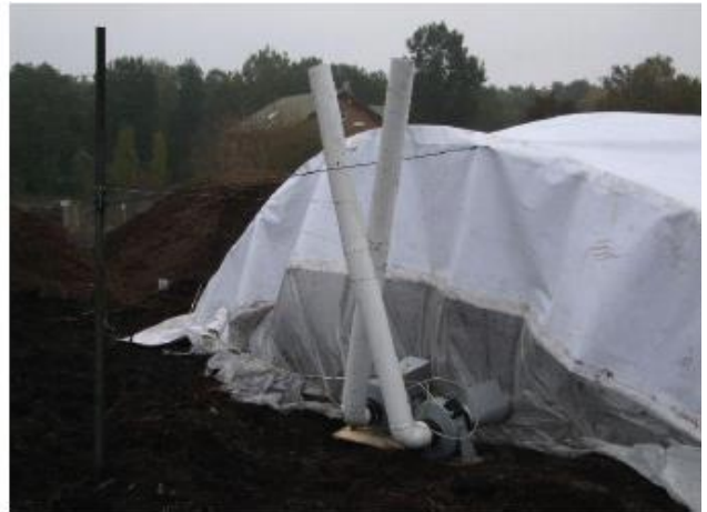
使用两个独立安装的风扇和供气管路将环境空气鼓入风洞中 (风洞前视图)
