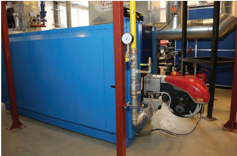
Abbildung 13: Die seit August 2013 in Betrieb genommene Strohheizungsanlage in Gülzow (Mecklenburg-Vorpommern) besteht aus einem 1.000 kW-Strohheizkessel. Jährlich kommen etwa 500 bis 600 t Stroh aus der Region zum Einsatz, die rund 500 \text{ t}_{\text{CO}_2\text{-Äq.}}/\text{kWh} ein. Quelle: Fachagentur Nachwachsende Rohstoffe e.V. (FNR)
