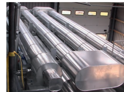
Vorbehandlung biologischer Abfälle durch Thermodruck-Hydrolyse (TDH), Quelle: R. Scheuchl GmbH, www.scheuchl.de
