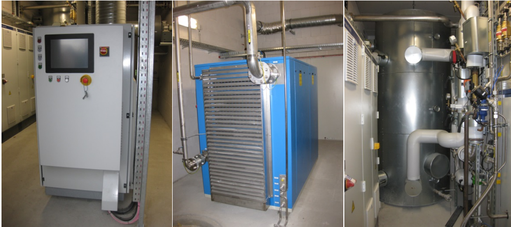
Abbildung 30: Komponenten des Mikrogasturbinen-BHKWs: a) Mikrogasturbine CPS 100, b) Holzgaskompressor und c) Heißwasser-Pufferspeicher
