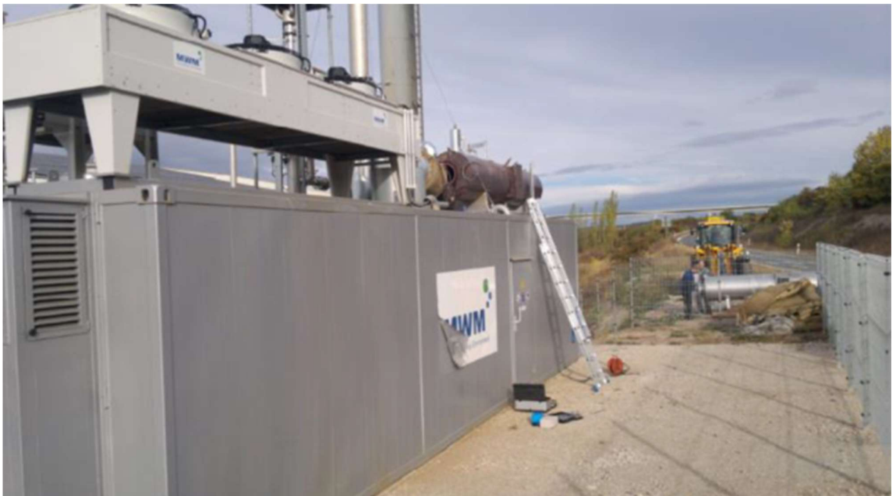
Abbildung 51 Fotografie des BHKW am Standort Karsdorf
