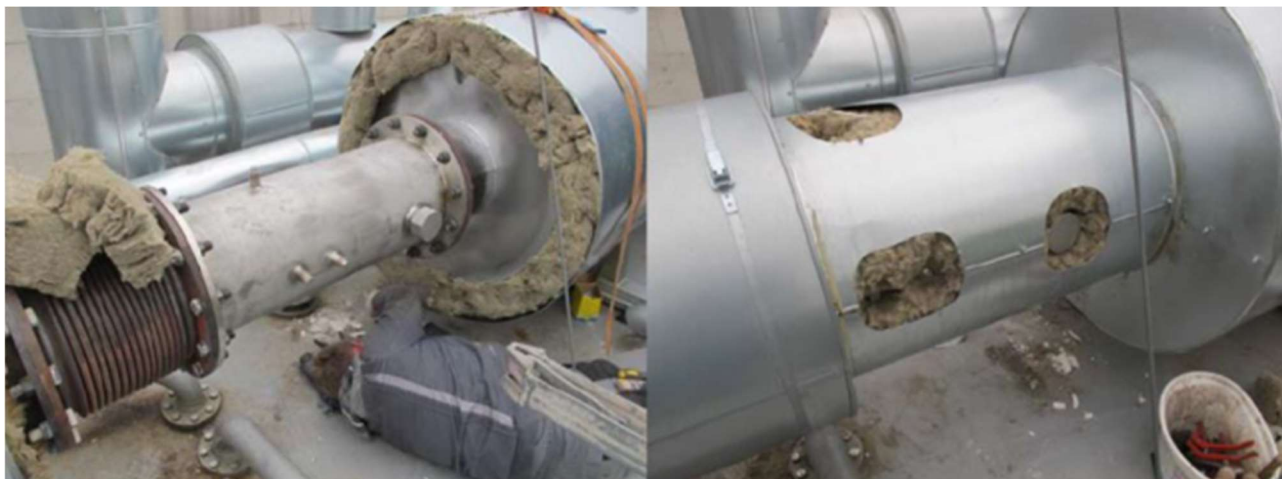
Abbildung 55 Fotografien der Staubprobenahme und Emissionsmessstelle vor Katalysator (links ohne, rechts mit Isolierung)
