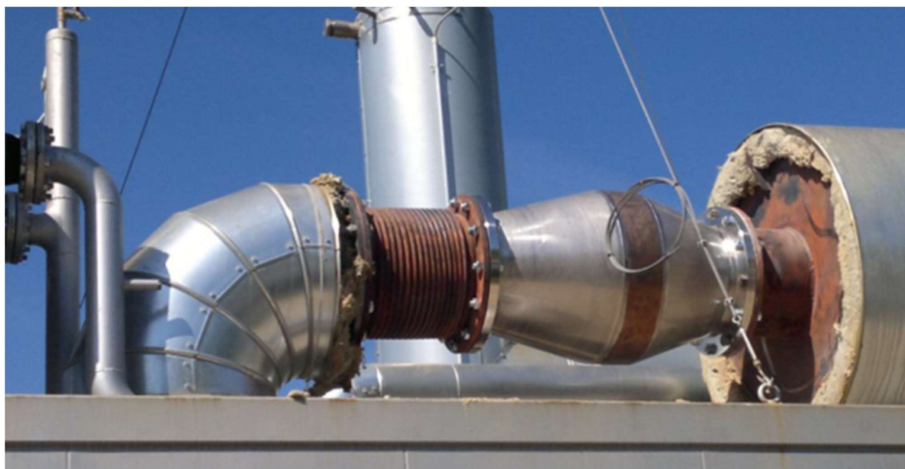
Abbildung 60 Fotografie des am BHKW Karsdorf installierten Vorkatalysators vor Anbringung des Isolationsmaterials
