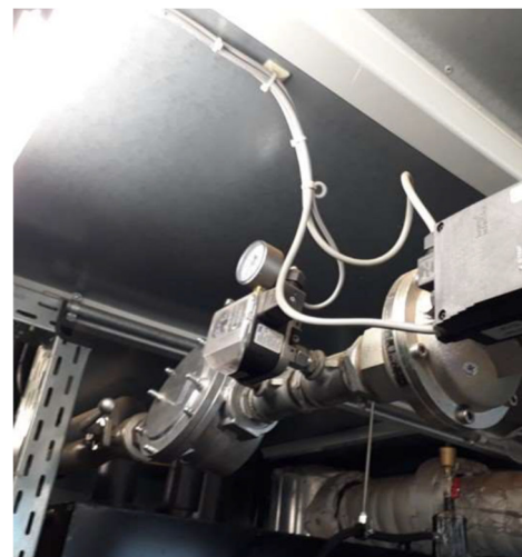
Abbildung 42: Gasregelstrecke der Biogasanlage BTV (Quelle BTV)
