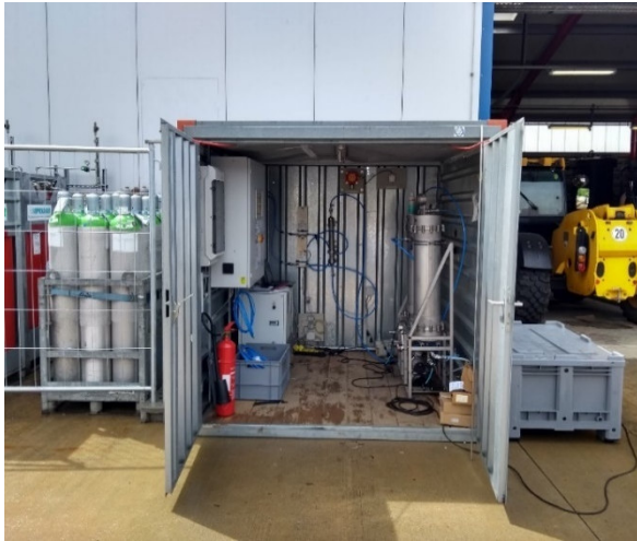
Abbildung 33: Aufstellungsort der Adsorberanlage vor dem GICON® Biogastechnikum, Gasversorgung links
