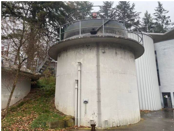
Abbildung 4-27 Faulturm LFKW mit einem Fassungsvermögen von 320 m 3
