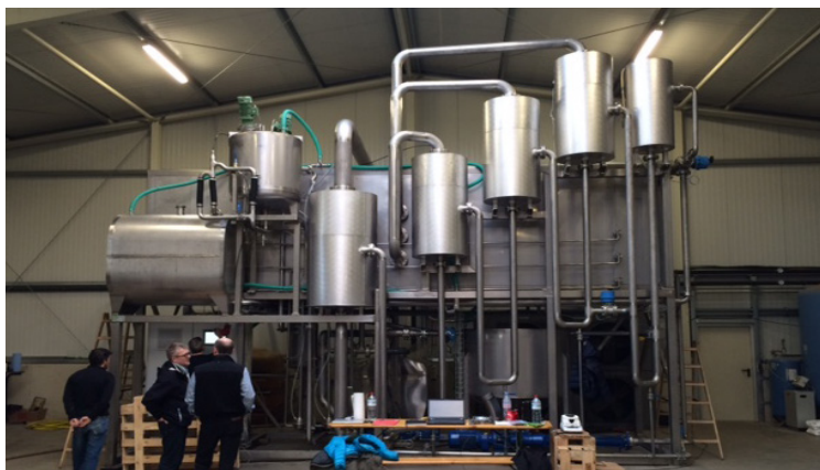
Bild: 4-stufige Verdampferanlage für die Entwässerung von flüssigen Gärresten (Foto: Rückert NatUrgas GmbH)
