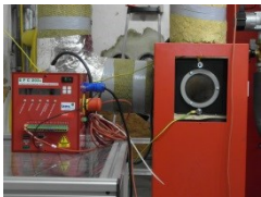
Bild 3: 20180525 Bild 3 Steuer- und Kontrolleinheit.jpeg BU: Fernwart- und steuerbare Kontroll- und Regelungseinheit des Abscheiders(Quelle: IZES)
