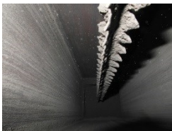
Bild 1: 20180525 Bild 1 Innenansicht Abscheider.jpeg BU: Innenansicht des Abscheiders (Quelle: IZES)
