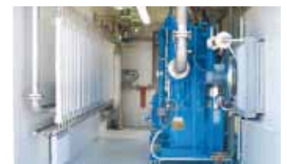
Biogas treatment facility Bruck an der Leitha, photo: ARGE Kompost & Biogas Österreich
